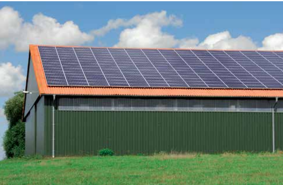
Reithalle mit Photovoltaik-Anlage
